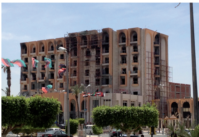
Viel zu tun: zahlreiche Gebäude in Libyen sind beschädigt
